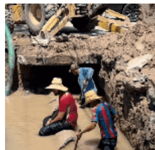
Drenaje de Matamoros al punto de colapso por la antigüedad de tubería
